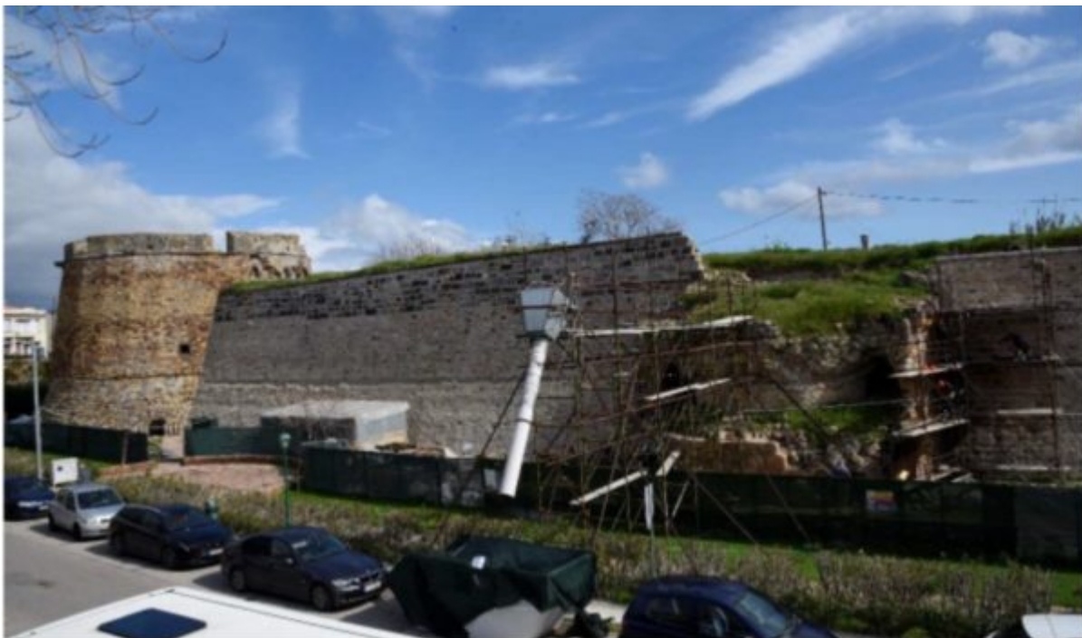
Άποψη του Προμαχώνα Ε με το τμήμα του τείχους που έχει καταρρεύσει
