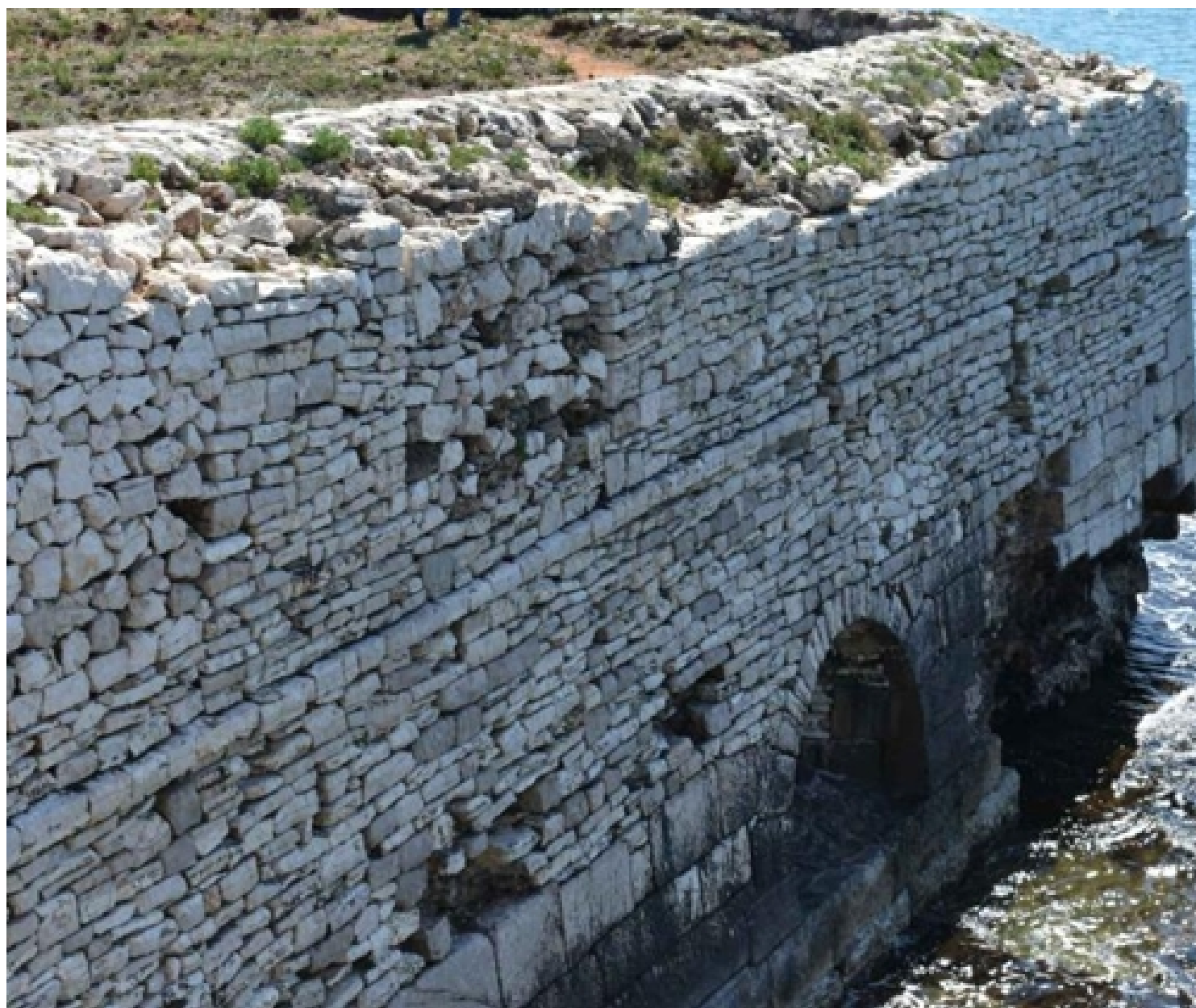
Ο επιθαλάσσιος περίβολος στα δυτικά. Στο άκρο του τείχους εντοπίζεται εκτεταμένη απώλεια
