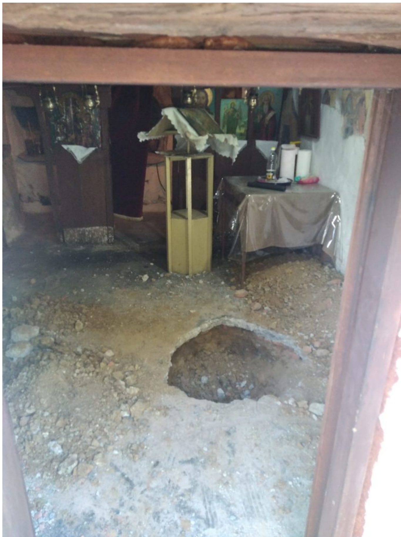
Μια τεράστια τρύπα είχε δημιουργηθεί στο δάπεδο του εσωτερικού του ναού
